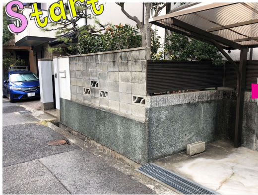
劣化が進行したブロック塀を
